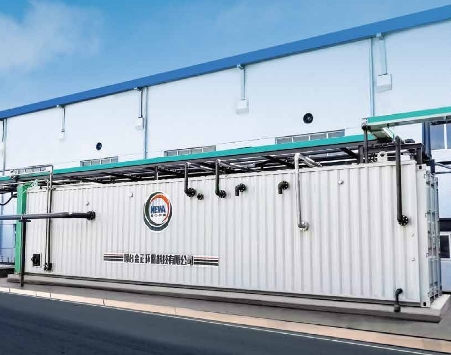
新疆伊犁某煤化工废水零排放项目 1000m 3 /d(一期) 1000m 3 /d(二期)
