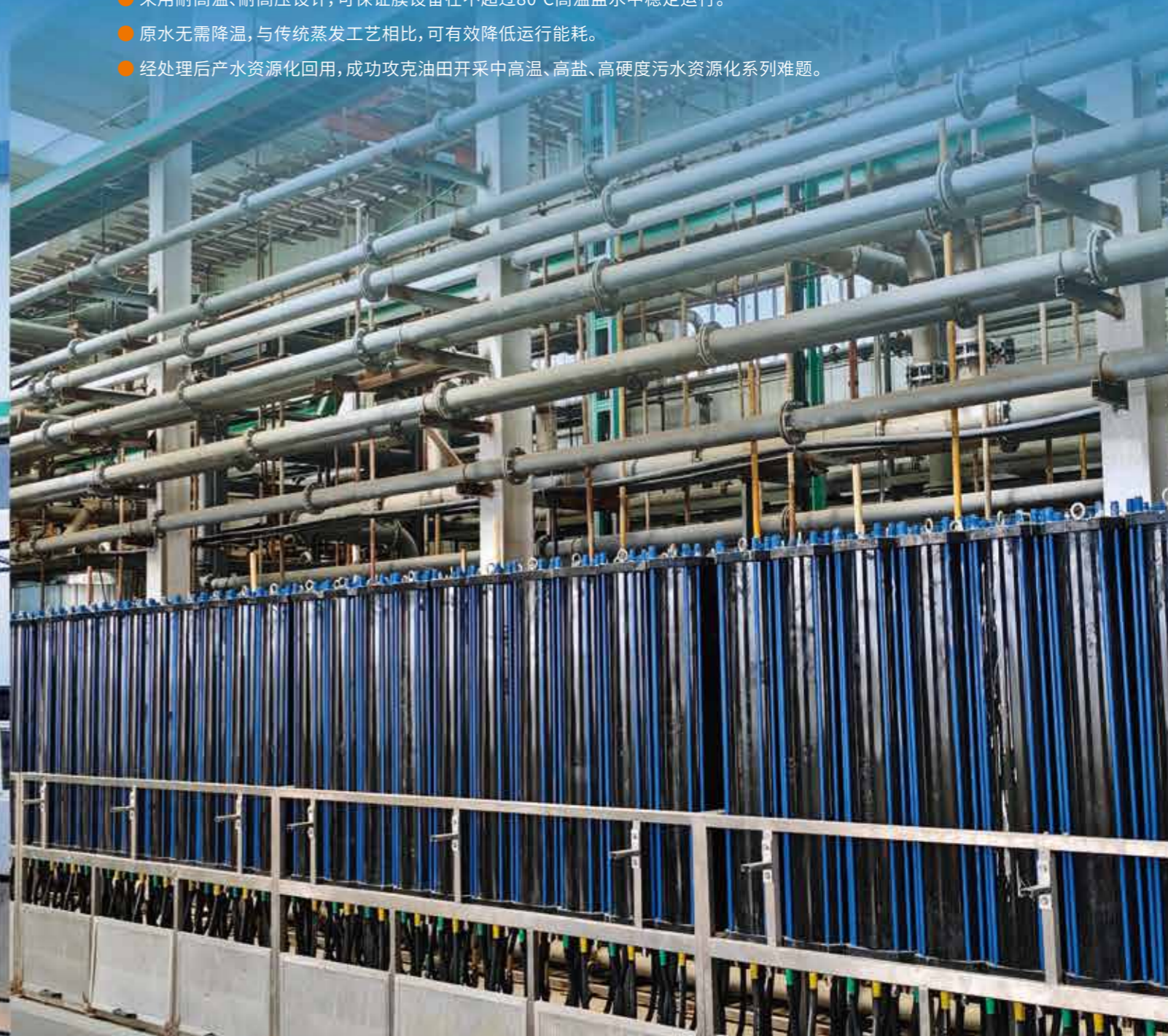
中石化某油田高温采出水项目 10000m 3 /d
